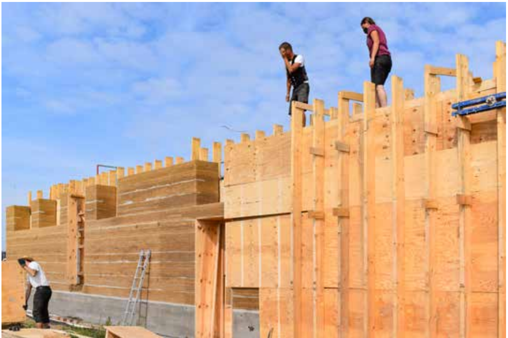
7 Um Bauherren von massiven Lehmkonstruktionen zu überzeugen, braucht es mehr Vorzeigeobjekte. Aktuell entsteht am Ringheiligtum Pömmelte (Salzlandkreis) ein Stampflehm-Neubau, der als Besucherzentrum dienen wird. Es handelt sich nach über 60 Jahren um den ersten öffentlichen Massivlehm-bau in Sachsen-Anhalt. (Foto: GOLEHM, 2021)
